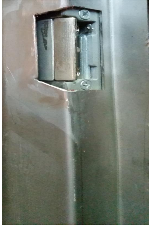
Figure 10 : Gâche électrique liée au boîtier.
